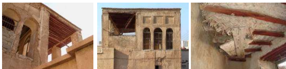
Figure 72 : Toits plats réalisés avec du Chandal, feuilles de palmier et de terre d'argile
