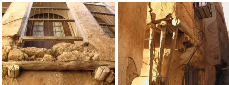
Figure 71 : Chandal (poutres en bois), dans les ruelles de la ville de Bushehr
